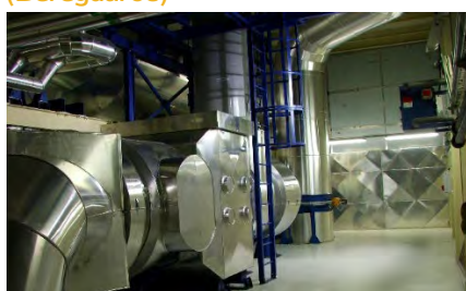
Электростанция Уйпалота (Újpalota)
