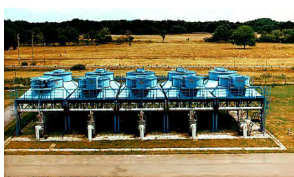
Компрессорная станция Берегдароц (Beregdaróc)
